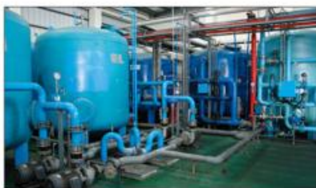
水處理設備 Water treatment
